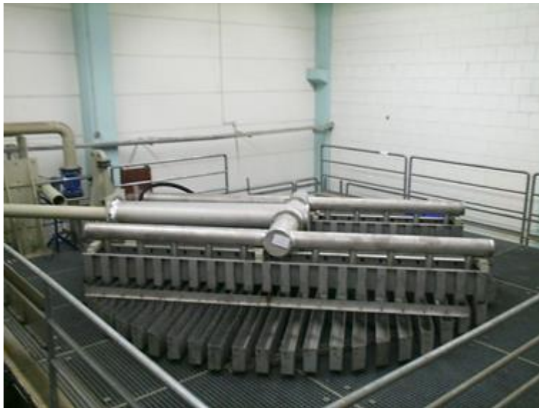
Rinnenverteiler montiert auf Verteilerprüfstand
